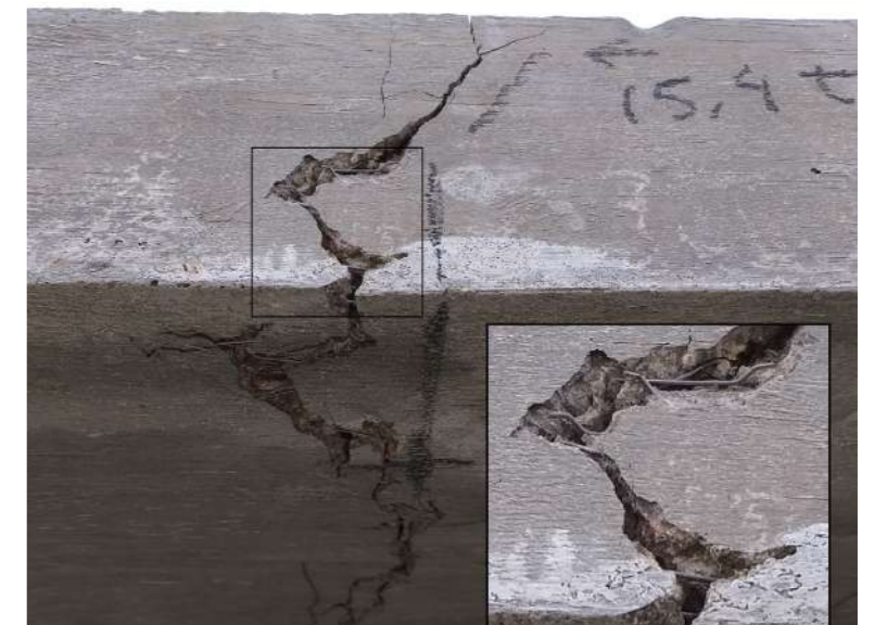
∞ Losa fisurada luego del ensayo. Se pueden ver las fibras. Fuente: Luis Segura.
